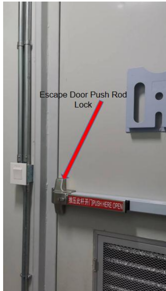
Escape door push rod lock
